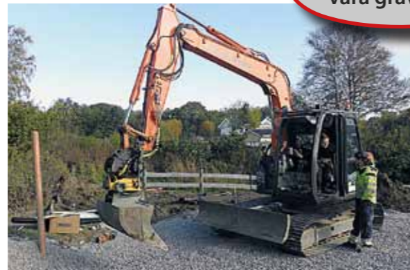
Martin Hansson testar iDig 2D Touch-systemet vid den husgrund han jobbar med just nu. Perfekt för ändamålet, kan han konstatera.
